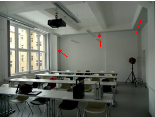
Bild 9: Kanten-Absorber in einem Hörsaal der MHMK [6]
